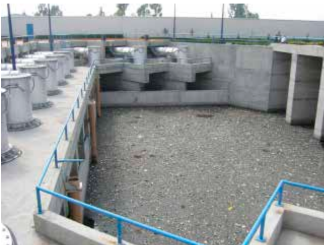
Figura 1: pozzo per acque reflue coperto di detriti galleggianti.
