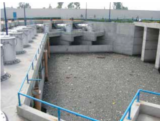
Esempio di stazioni tipiche per acque reflue con pompe a elica.
