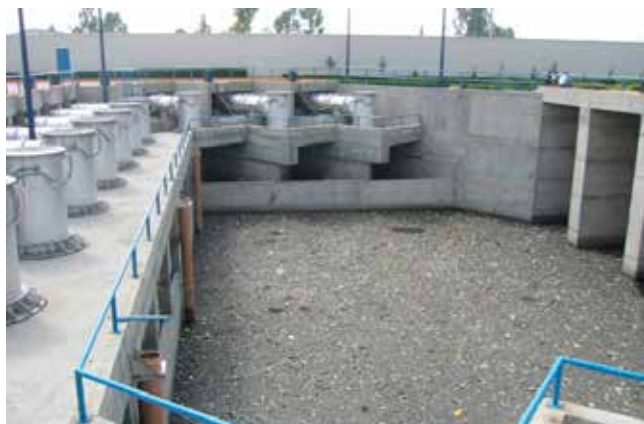
Figure 1: Une bêche de pompage couverte de débris flottants
